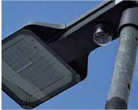
mastap-Monitoringverfahren – Schwingungssensor integriert im Leuchtkörper.
